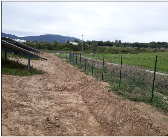
Abbildung 15: beispielhafte Verwallung zum Rückhalt von Oberflächenwasser in einem Solarpark
